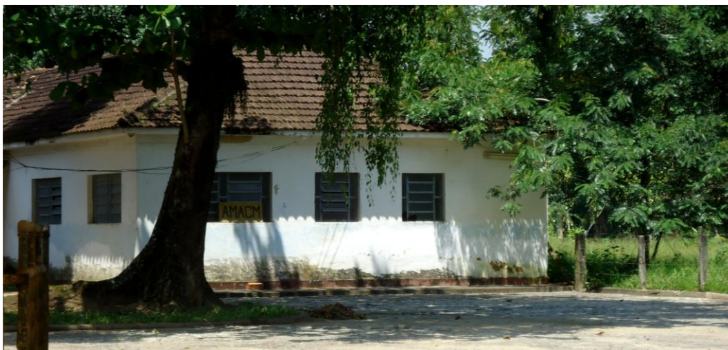
Foto 15 – Prédio atual da AMACM, provisoriamente desativado por problemas estruturais. Foto: Elisa dos Anjos
