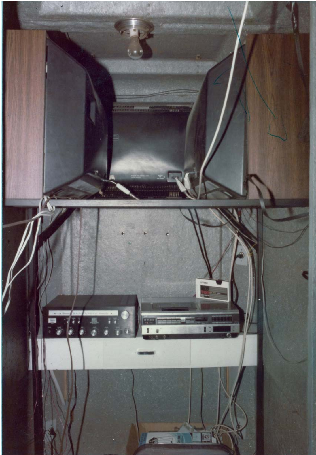
Figura 14 - Cabina por dentro
