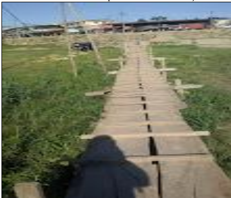
Foto 2 - Ponte 35 de madeira para acesso à embarcação fluvial
