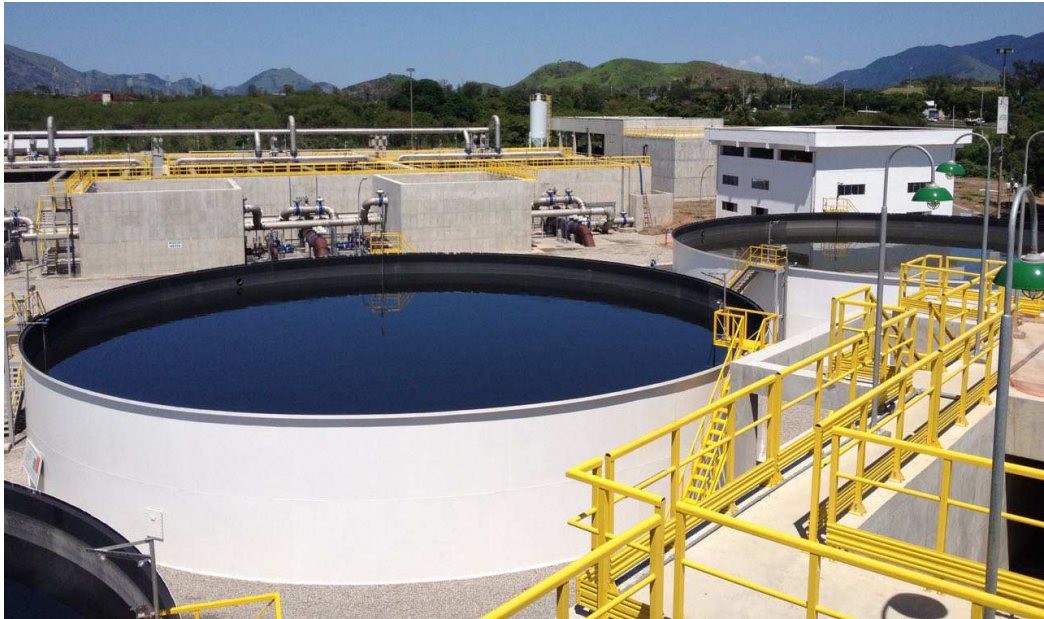
Figura 19 - Tanque de equalização.
