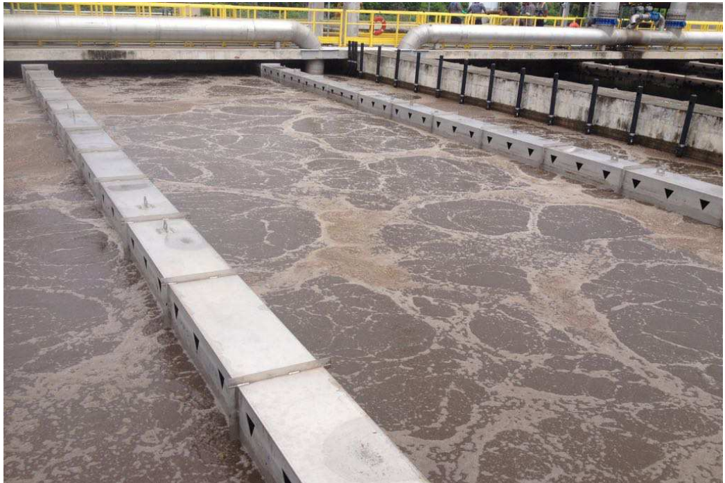
Figura 21 - Reator biológico em fase de aeração.
