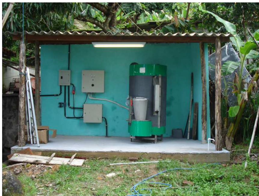
Figura 3. Foto do reator instalado na Escola Municipal Brigadeiro Nóbrega, localizada na Vila de Abraão, Ilha Grande, RJ (Foto: Rodrigo S. Muniz, 2009).
