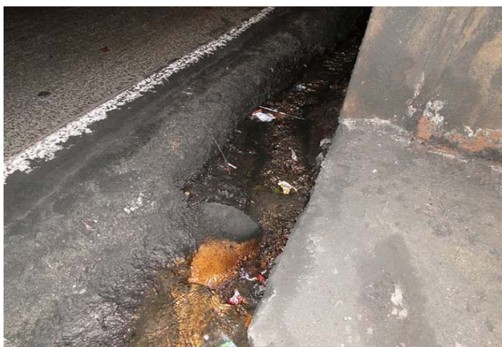
Figura 14 – Calhas do sistema de drenagem da pista
