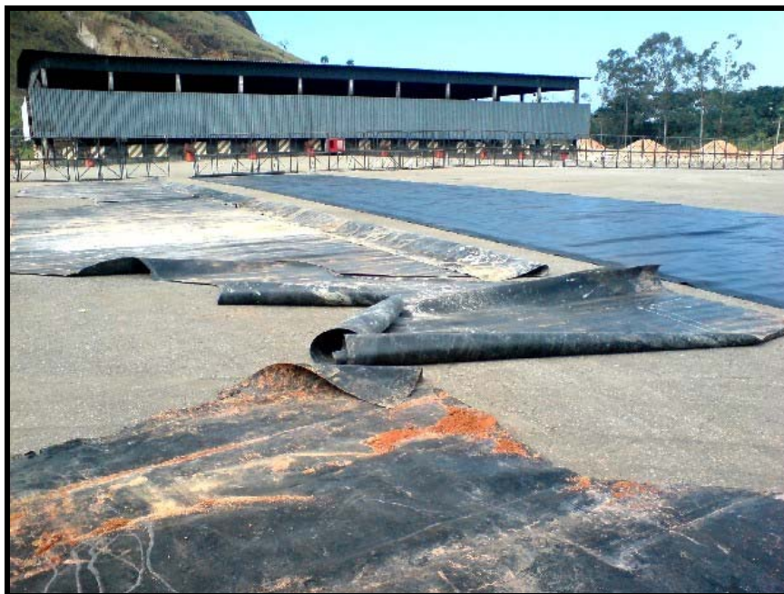
Figura 29 – Manta de PEAD danificada (à esquerda) e manta nova (à direita)
