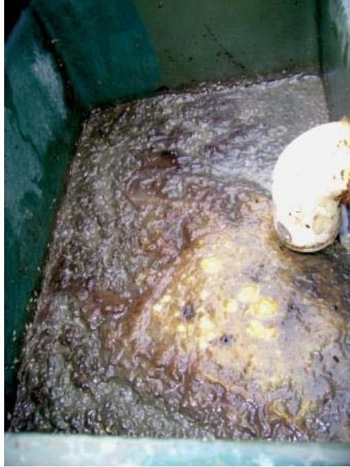
Figura 11 - Interior da caixa de gordura (Foto: T. Freitas).
