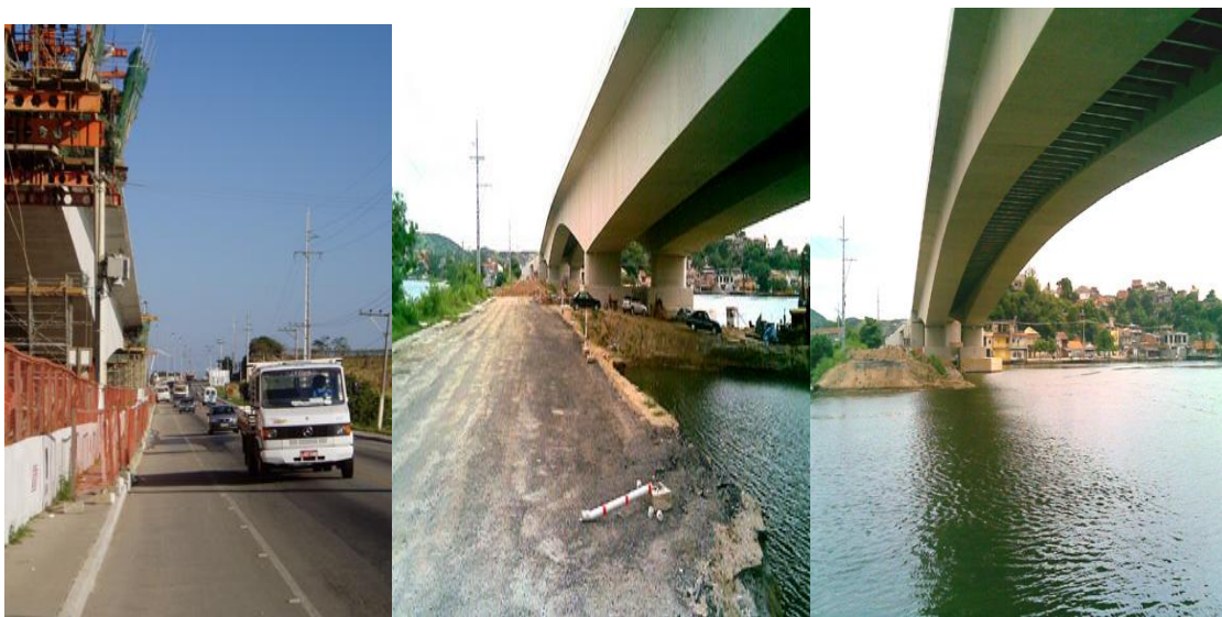
Figura 33- Construção da nova ponte sobre a Ponta do Ambrósio (Cabo Frio- São Pedro da Aldeia) Fonte: http://www.jornalprimeirahora.com.br/noticia/6019/Pontes-estao-sendo-feitas-com-mao-dupla-e-com-duas-pistas-de-rolamento
