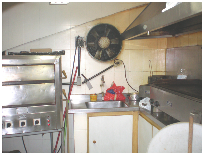
Figura 10: Cantina Bloco F (9º Pavimento) (Detalhe do exaustor)
