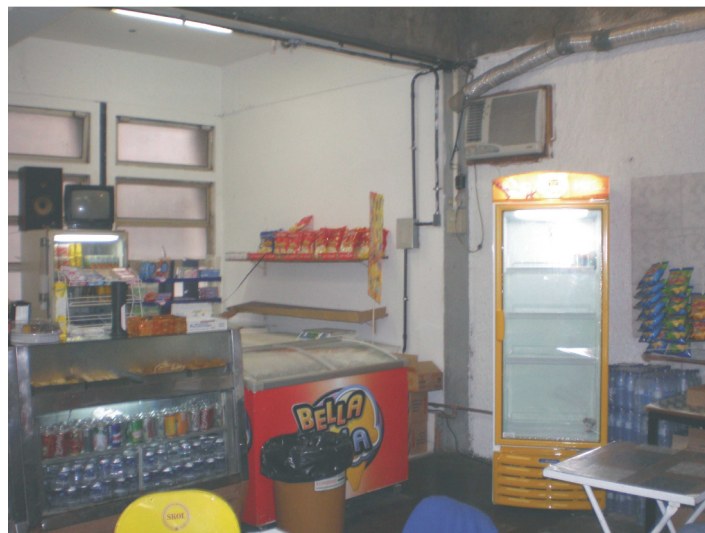
Figura 14: Cantina Bloco C (3º Pavimento) (Detalhe da parte elétrica)
