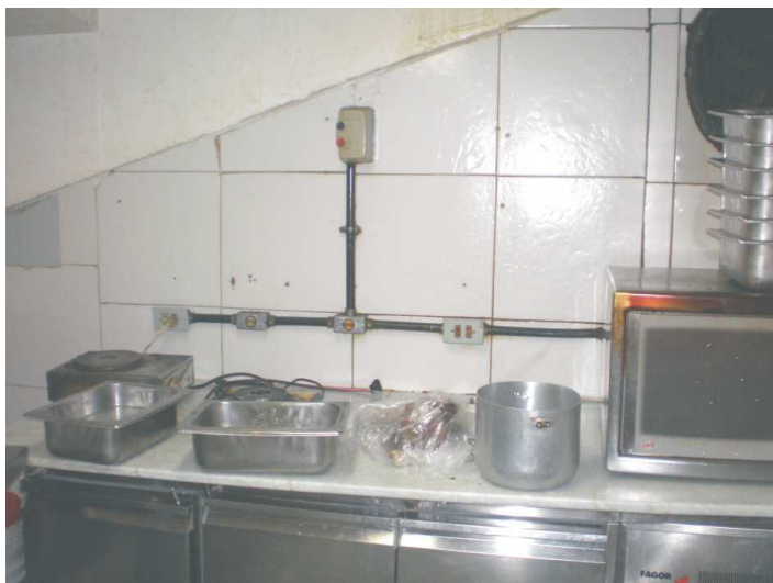
Figura 5: Cantina Bloco F (3º Pavimento) (Detalhe da instalação elétrica)
