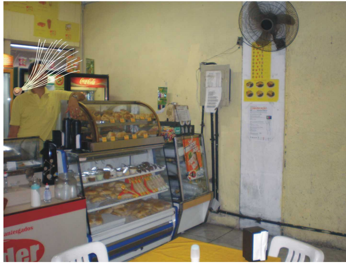
Figura 19: Cantina Bloco C (11º Pavimento) (Detalhe do quadro elétrico)
