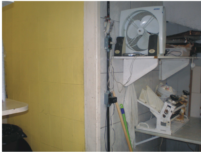
Figura 9: Cantina Bloco F (9º Pavimento) (Detalhe da instalação elétrica)
