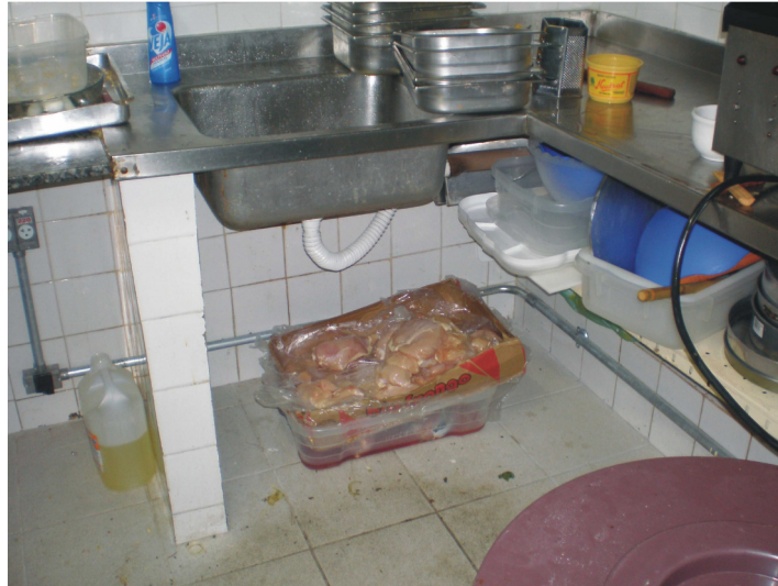
Figura 11: Cantina Bloco F (11º Pavimento) (Detalhe alimento em descongelamento)
