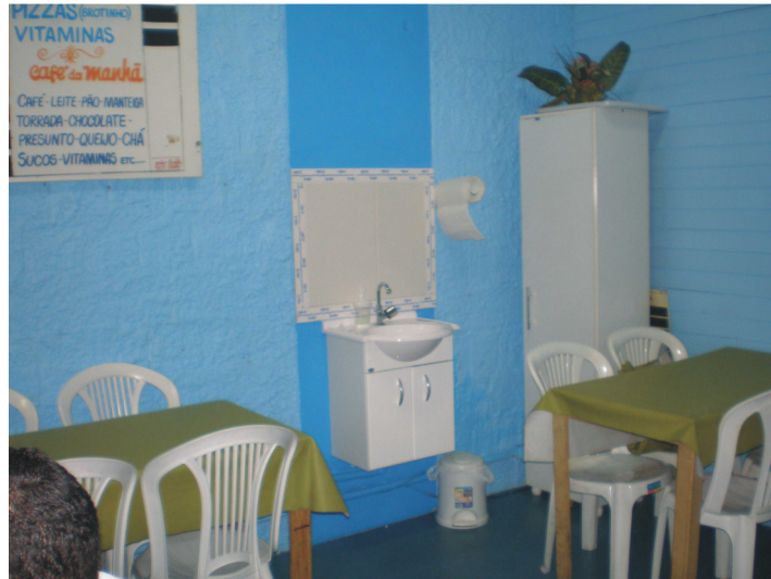
Figura 15: Cantina Bloco C (5º Pavimento) (Detalhe do lavatório)
