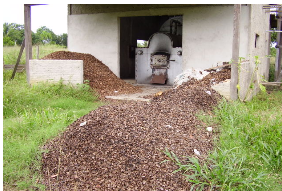
Figura 19. Foto da caldeira da fábrica da COMAJA e vista dos montes de cascas de castanha dispostas, que serão utilizadas para geração de vapor, utilizado na fábrica.
