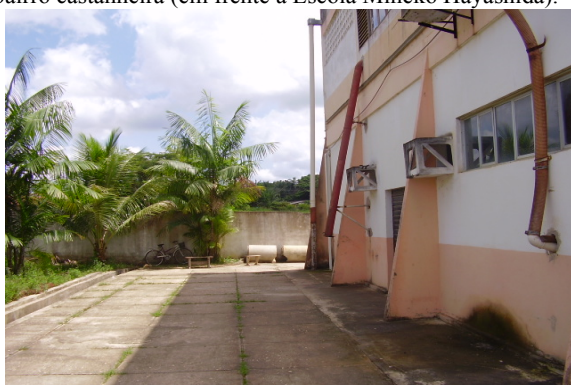
Figura 18. Detalhe do ducto de descarga para as cascas de castanha, oriundas do setor de descascamento, na lateral direita da fábrica, onde são segregadas, coletados e transportados até a caldeira para queima e produção de vapor.
