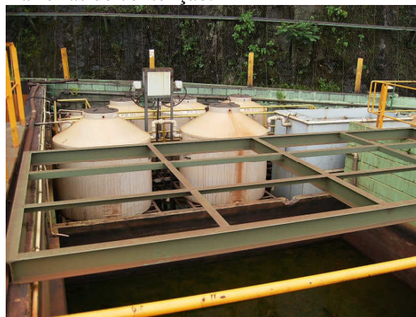
Estação de Tratamento de águas oleosas.
