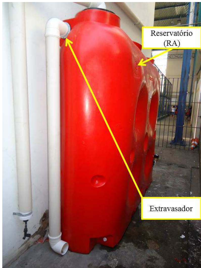
Figura 18: Reservatório de Armazenamento (RA).
