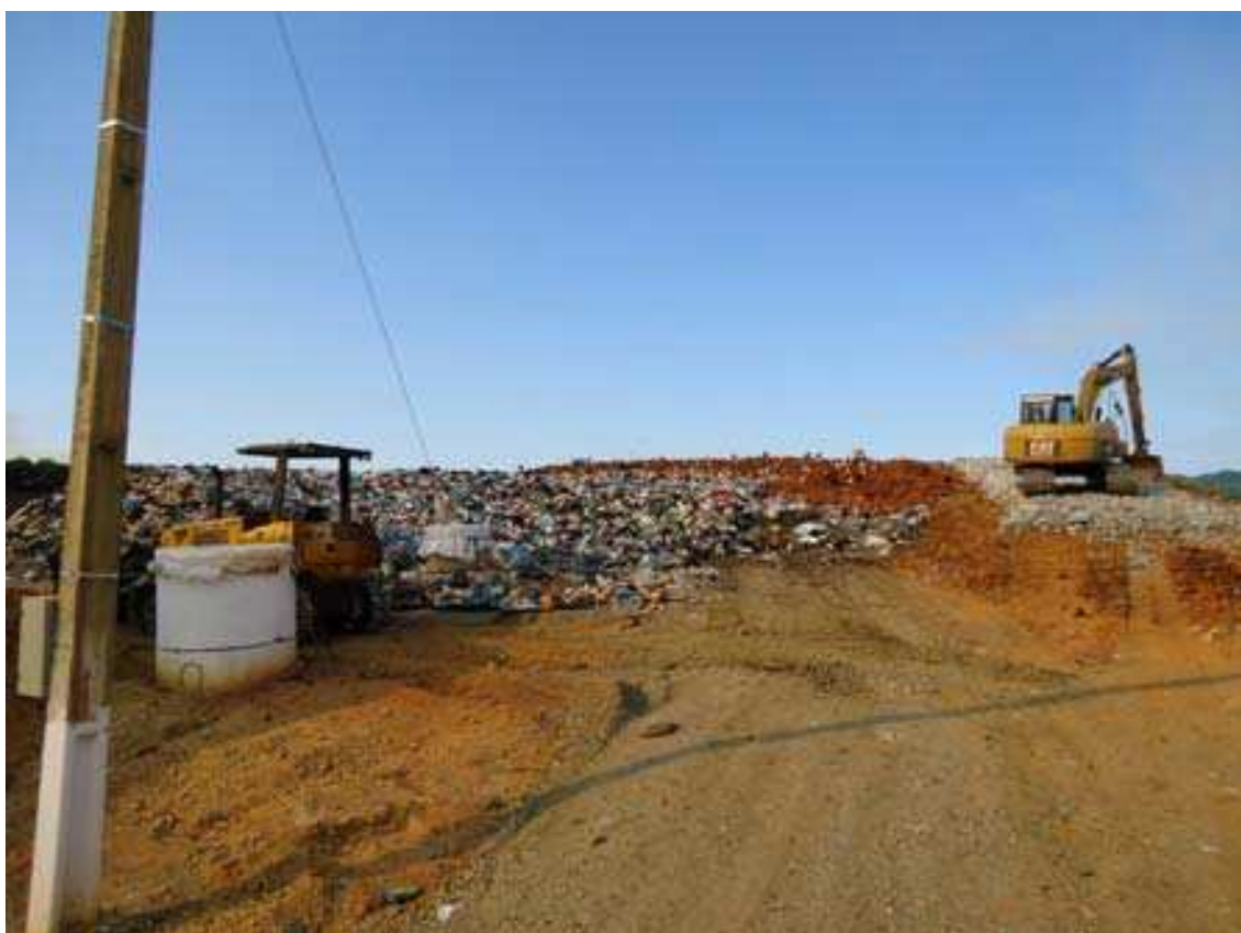
Figura 25: Frente de operação. Fonte: ABES-SC, 2012.
