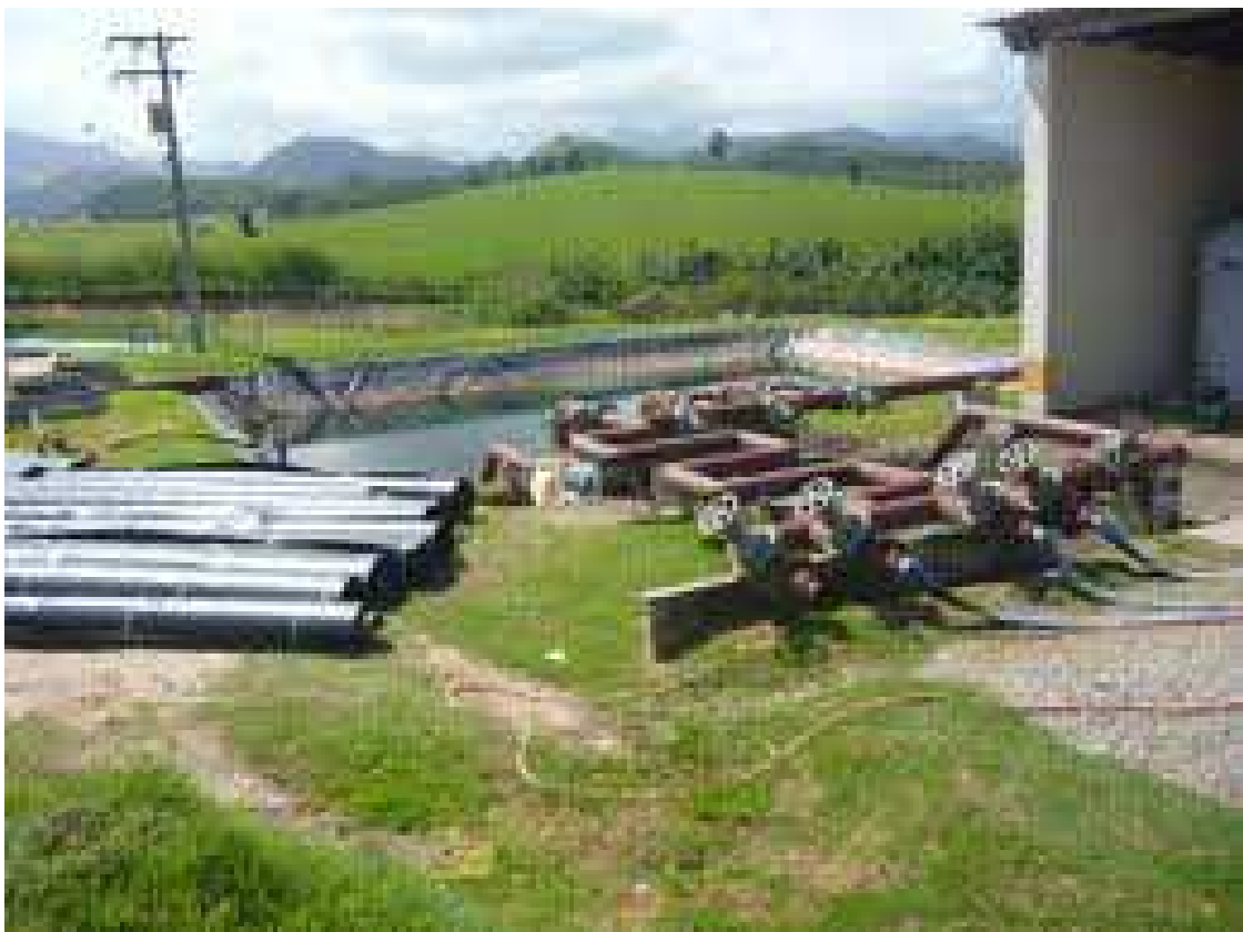
Figura 22: Sistema de bombeamento de lixiviado bruto do aterro de Rio das Ostras.
