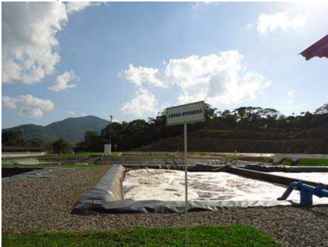
Figura 29: Etapa de lodos ativados. Fonte: ABES-SC, 2012.
