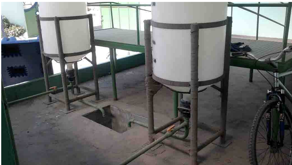
Figura 67. Área de armazenamento de óleo de cozinha.
