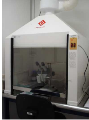
Figura 14 – Capela de exaustão de gases Fonte: Adriana Zwetsch
