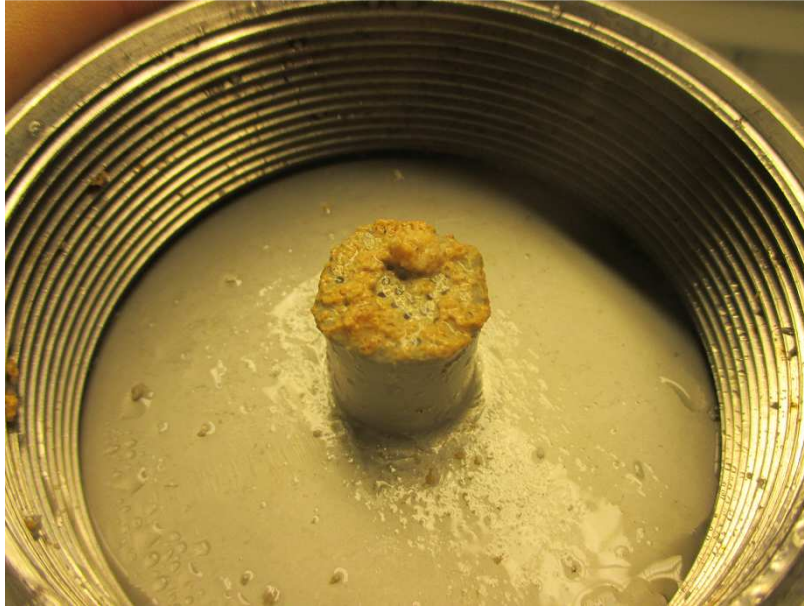
Figura 27 – Entupimento na entrada do retentor de espuma.
