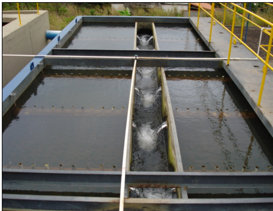
Figura 2.8 – Decantação em uma ETA. Fonte: Arquivo do Autor (2007).
