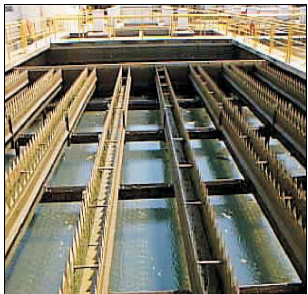
Figura 2.16 – Decantador sendo esvaziado para lavagem. Fonte: Reali (1999).
