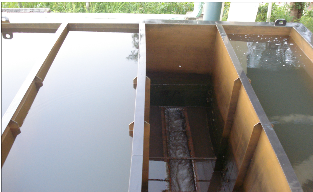
Figura 6.13 – Filtro sendo lavado. Fonte: Arquivo do autor (2006).
