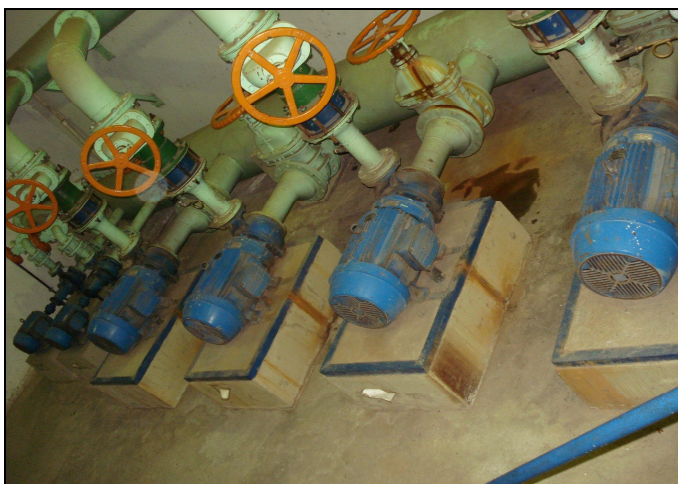
Figura 6.10 – Elevatória de água tratada. Fonte: Arquivo do Autor.
