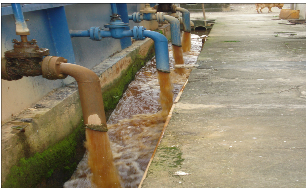
Figura 6.14 – Descargas de um decantador. Fonte: Arquivo do autor (2006).
