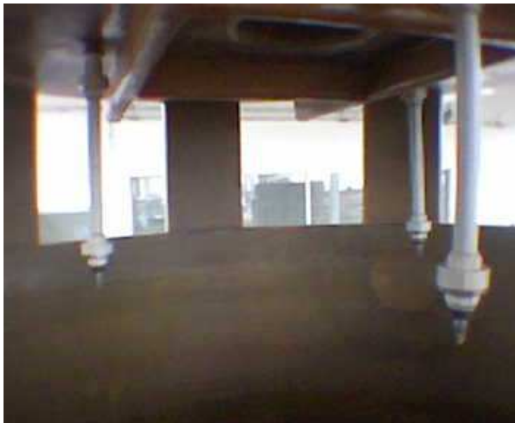
Aspecto dos bicos nebulizadores de umidecimento do leito de filtração
