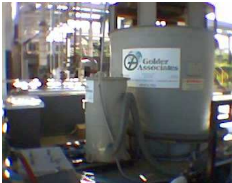
Conjunto de Biofiltração de Fluxo Ascendente
