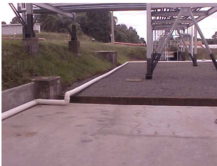
Dutos de sucção ligando Caixa de chegada do SAO ao Biofiltro
