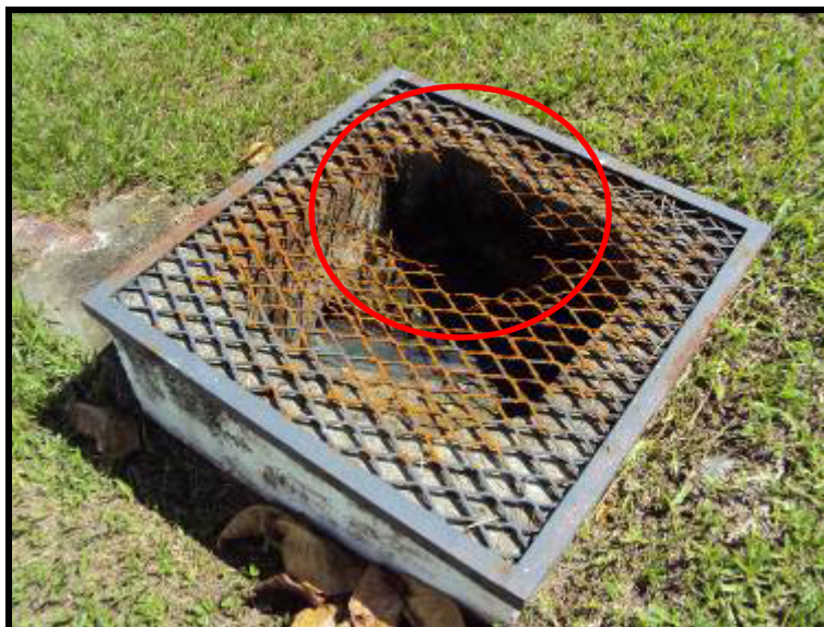
Figura 5.3 – Vista do poço de monitoramento com a grade de proteção quebrada e enferrujada.
