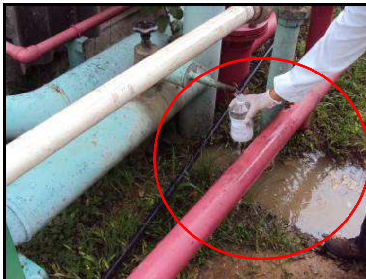
Figura 5.4 – Ponto de coleta de amostra com derramamento de efluente no solo.
