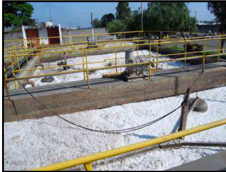
Figura 5.11 – Vista de um tanque de aeração com aeradores mecânicos superficiais apresentando espuma branca densa.
