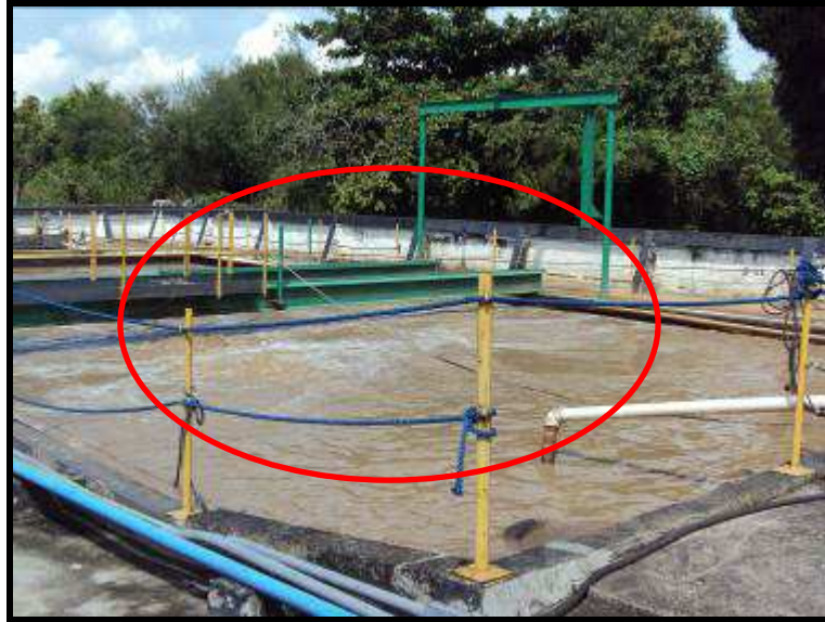
Figura 5.2 – Tanques de equalização de efluentes oleosos sem guarda-corpos adequados.
