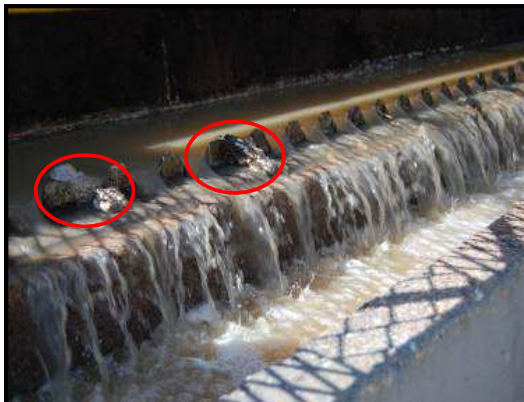
Figura 5.16 – Vista frontal da lâmina do vertedouro com acúmulo de lodo, provocando o mau escoamento de efluente no vertedor. Na figura estão indicados os pontos de acúmulo de resíduos.
