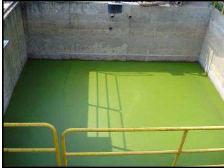
Figura 5.14 – Vista superior de um tanque com aeração com seu sistema de aeração paralisado, provocando a proliferação de algas.
