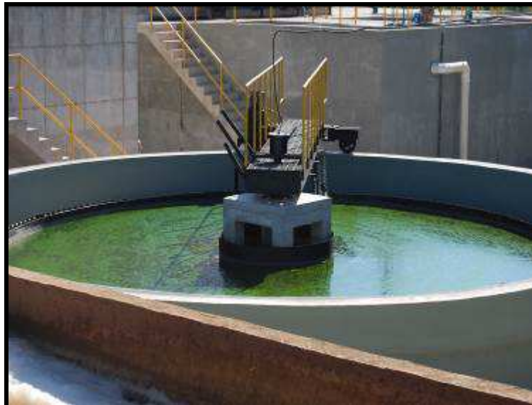
Figura 5.15 – Vista de um decantador secundário com tempo de retenção muito longo, causando a proliferação de algas.
