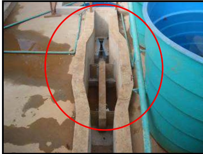
Figura 5.6 – Vista superior de um canal com caixa de areia, grade e Calha Parshall. A Calha Parshall encontra-se muito abaixo do solo, inviabilizando a medição correta de vazão.
