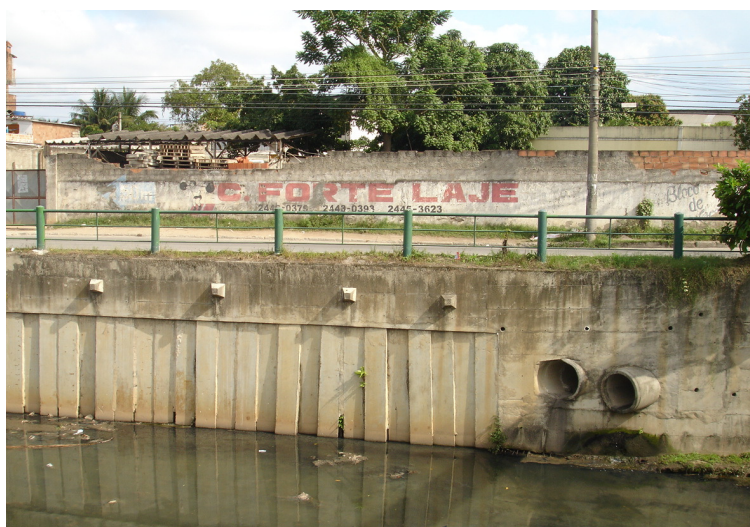
Figura 5.12. Lançamento de esgoto diretamente no Rio Anil.
