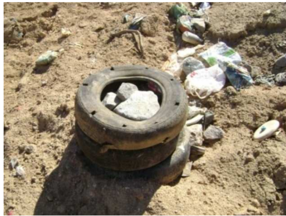
Figura 26 – Extremidade do Dreno Vertical – Aterro Sanitário de Pirai
