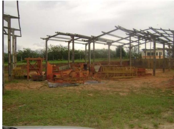
Figura 34 - Equipamentos da Central de Beneficiamento de RCC - CTR Rio das Ostras
