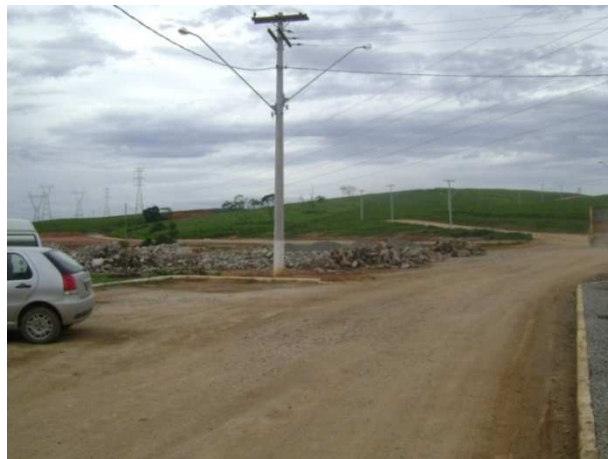
Figura 66 - Rede Elétrica Interna – CTR Macaé
