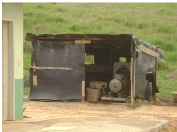
Figura 64 - Gerador - CTR Macaé
