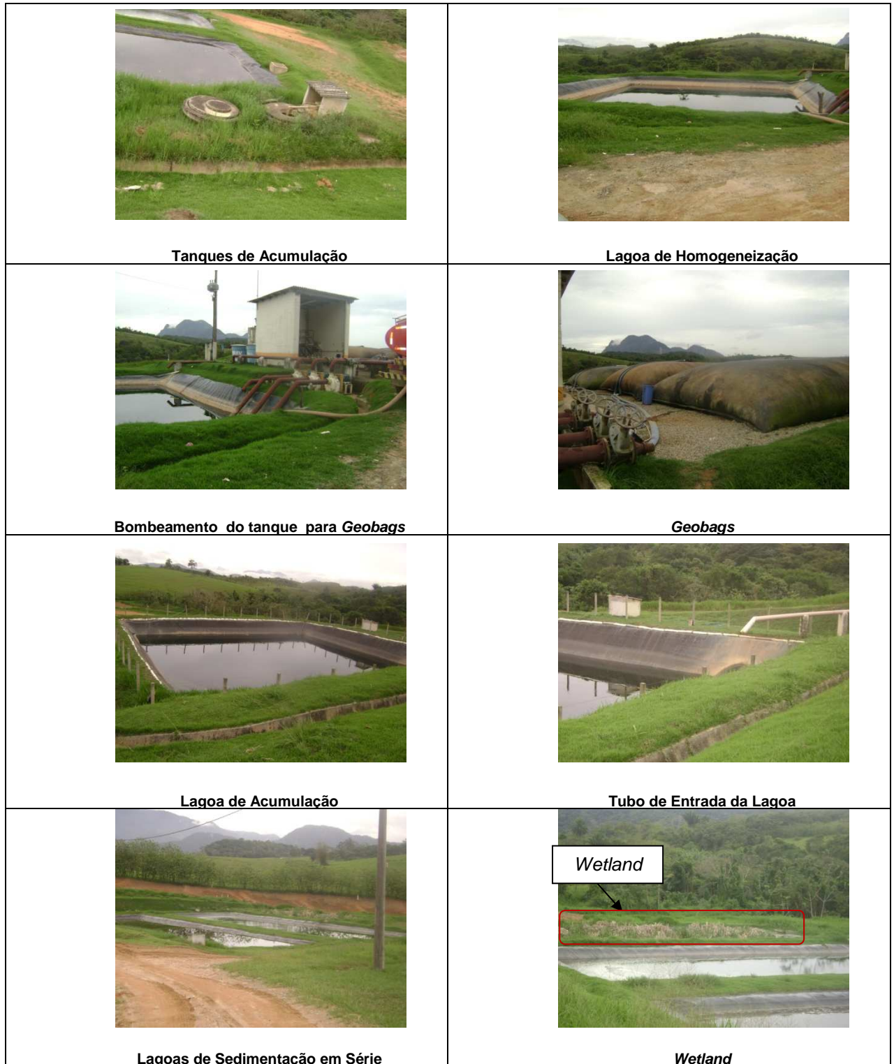
Figura 58 – Detalhes do Sistema de Tratamento de Chorume – CTR Rio das Ostras
