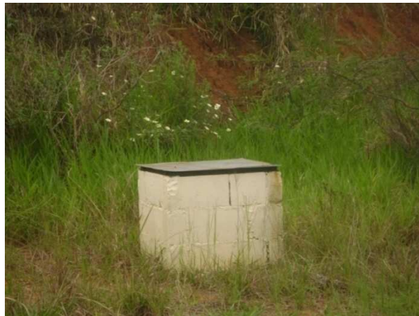
Figura 59 – Poço de Monitoramento de Águas Subterrâneas – CTR Rio das Ostras
