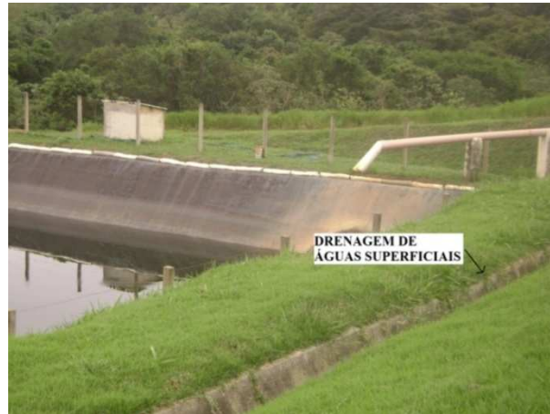
Figura 53 – Drenagem ao redor da lagoa de chorume – CTR Rio das Ostras
