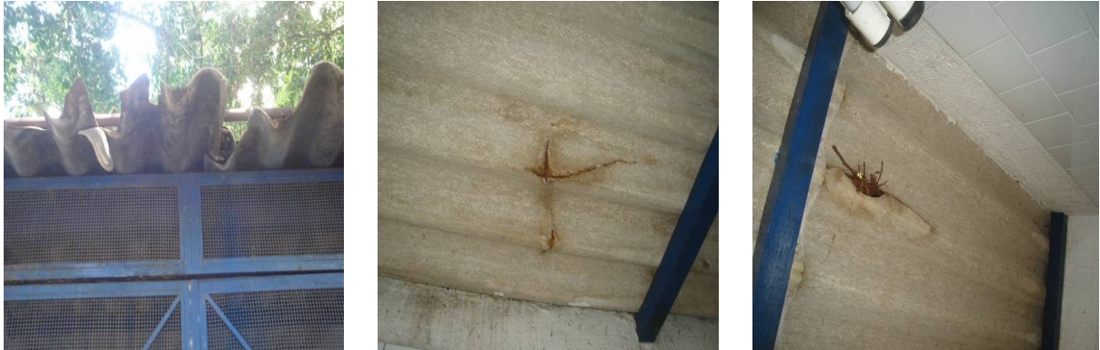
FIGURA 12 – Rachaduras no telhado do abrigo de resíduos da FOUERJ.
