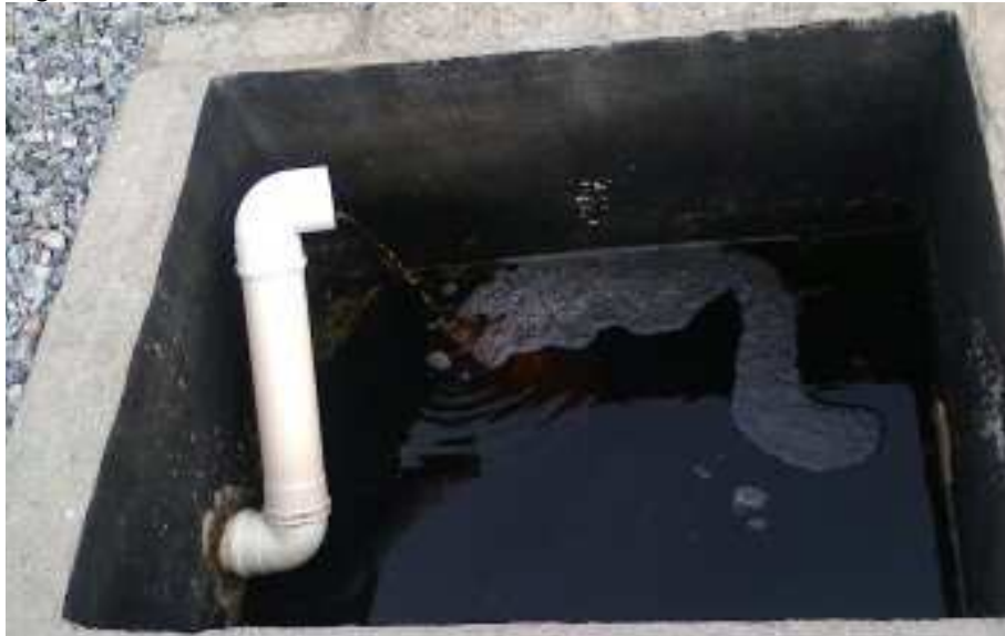
Figura 25: Detalhe do sistema de controle do nível do wetland
