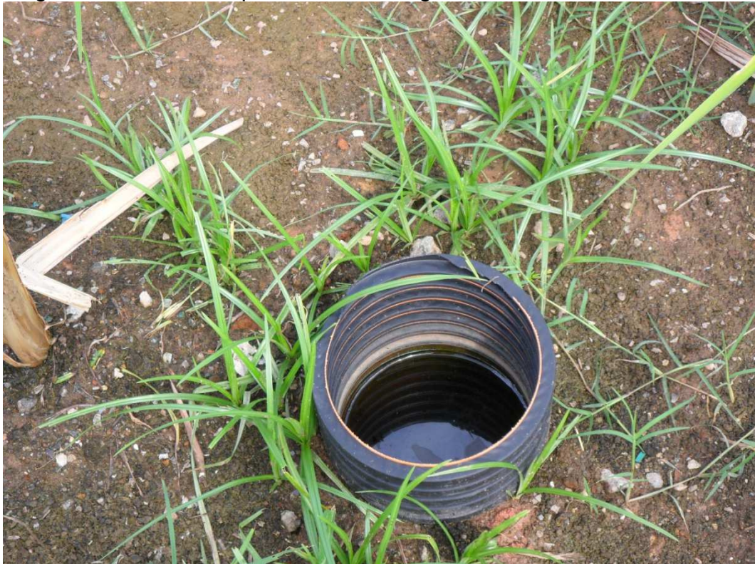
Figura 21: Detalhe do ponto de amostragem intermediário.
