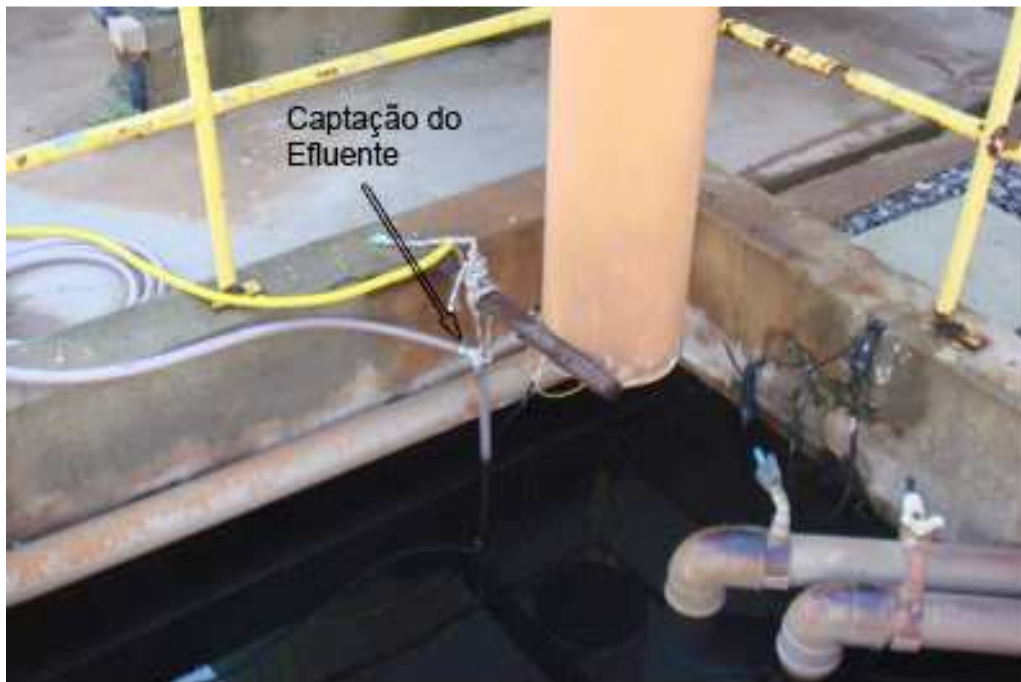
Figura 22: Ponto de captação do efluente
