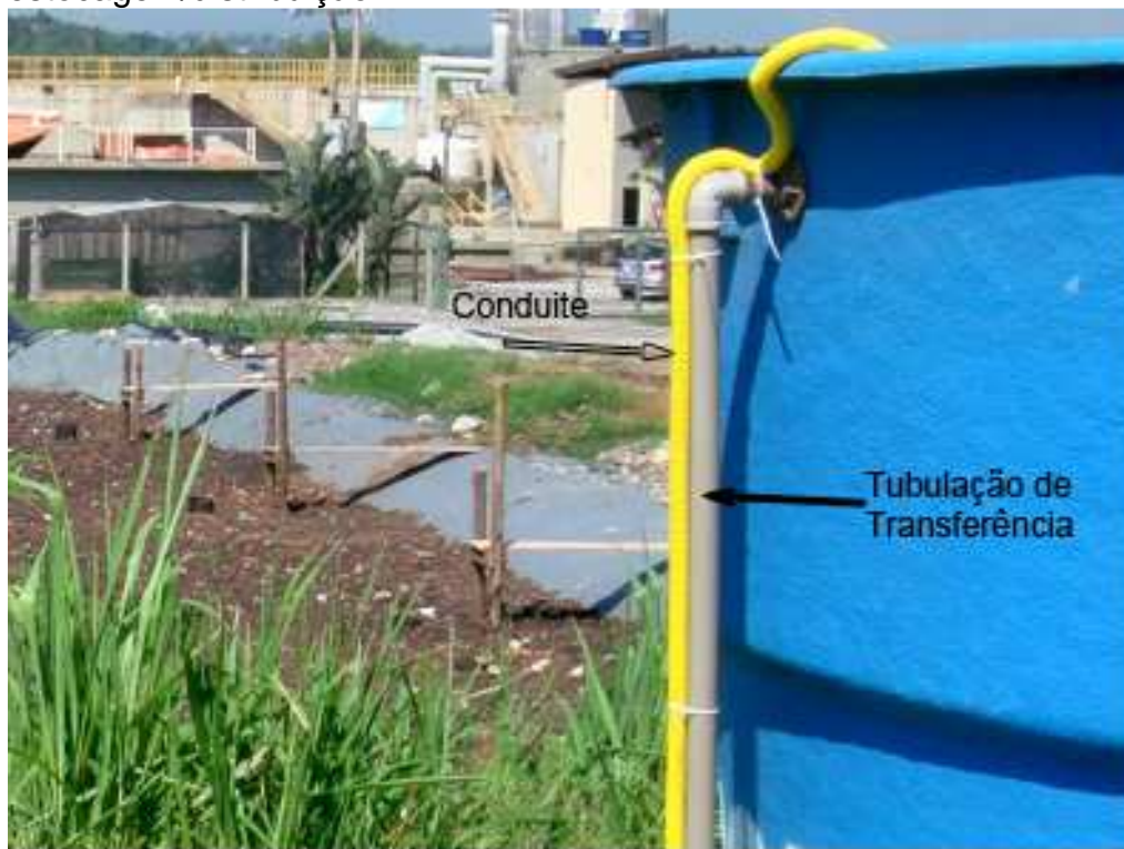
Figura 23: Detalhe do conduíte e da tubulação chegando na caixa de estocagem/distribuição.
