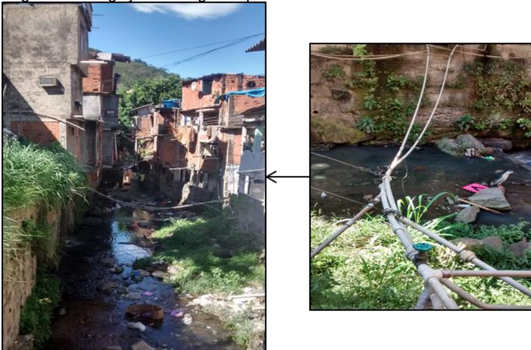
Figura 44 – Ligações de água improvisadas na comunidade da Indiana.
