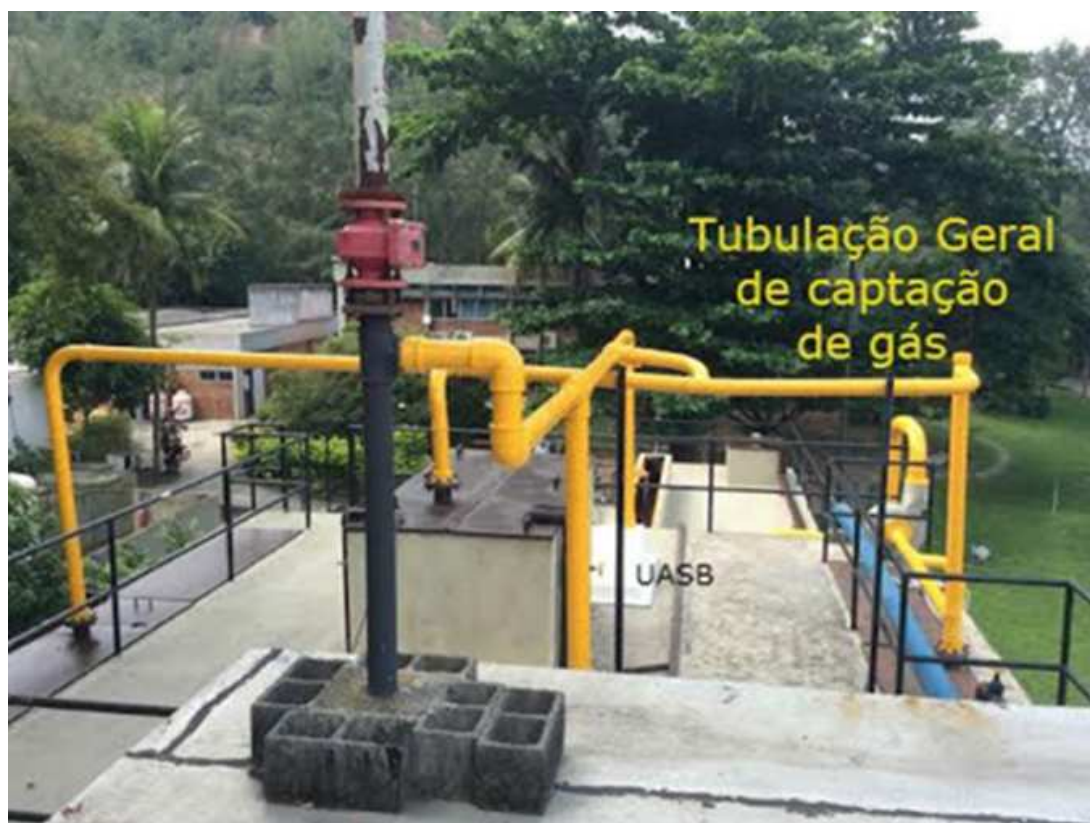
Figura 2.3 - Tratamento secundário do efluente na estação.
