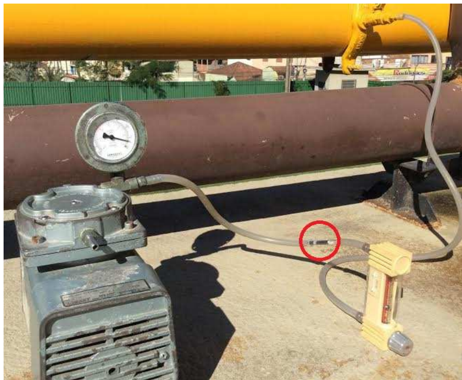
Figura 2.11 - Adsorção dos gases coletados direto na tubulação geral de gases da Estação.
