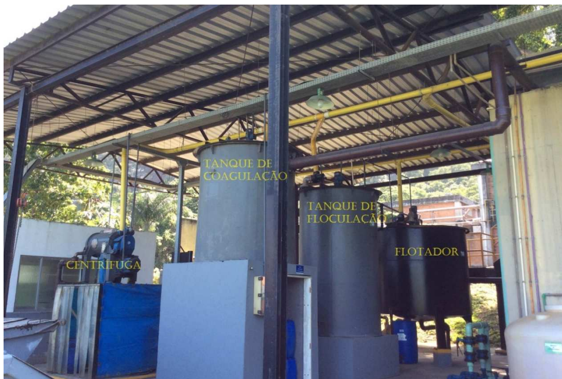
Figura 2.2- Tratamento primário do efluente na estação.
