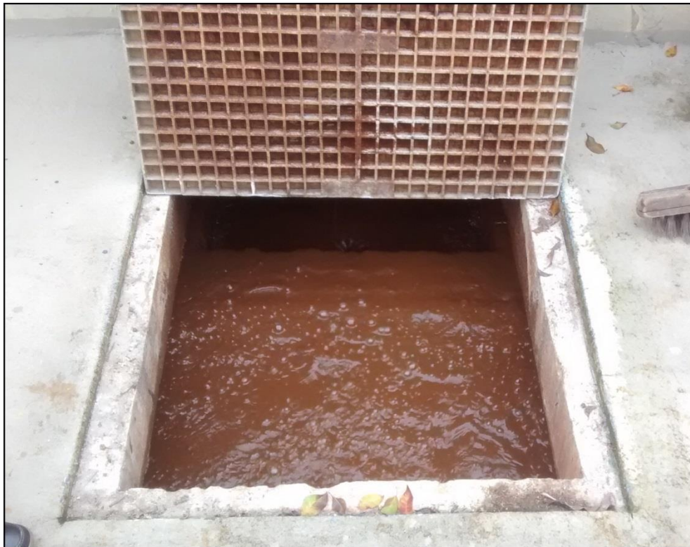
Figura 2.1 – Porta de acesso ao reator aeróbio da ETEI alimentícia
