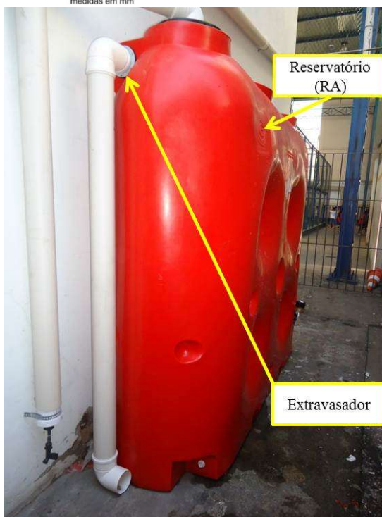
Figura 21: Reservatório com capacidade para 2.460 litros (Harvesting Brasil, 2012)
