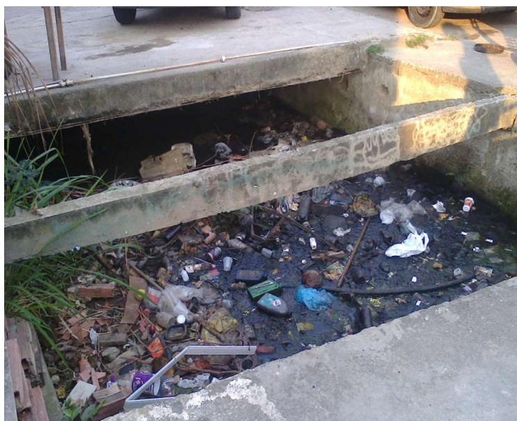
Figura 42. Galeria de esgoto – Rua Bernardo Sayão
