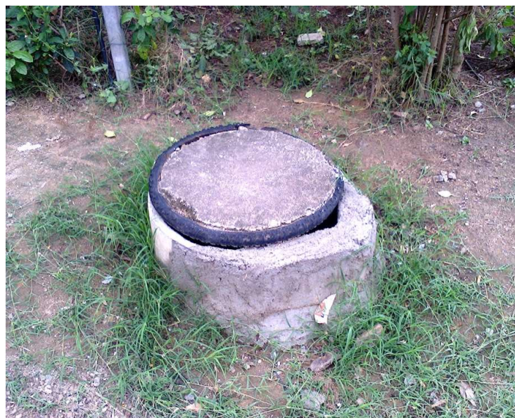
Figura 50. Foto. Sumidouro – Rua Magalhães Luiz
