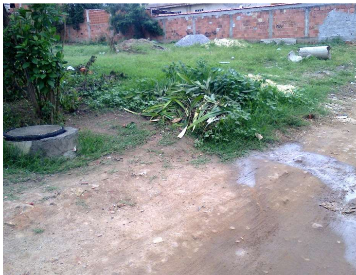
Figura 49. Esgoto emergindo – Rua Magalhães Luiz
