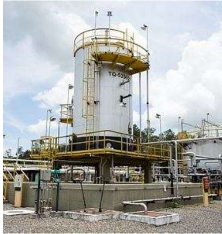
Figura 1 – Tanque elevado instalado em estrutura acima do nível do solo
