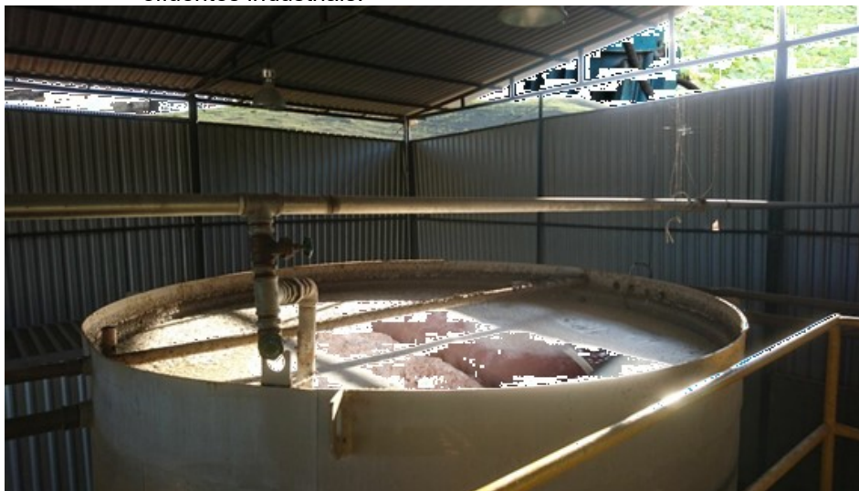
Figura 5 – Reator aeróbio de uma central multipropósito de tratamento de efluentes industriais.
