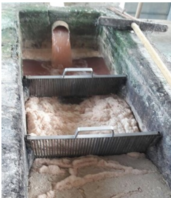
Figura 3 – Remoção de sólidos grosseiros
