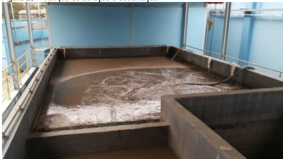
Figura 20 – Tanque de aeração e decantação
