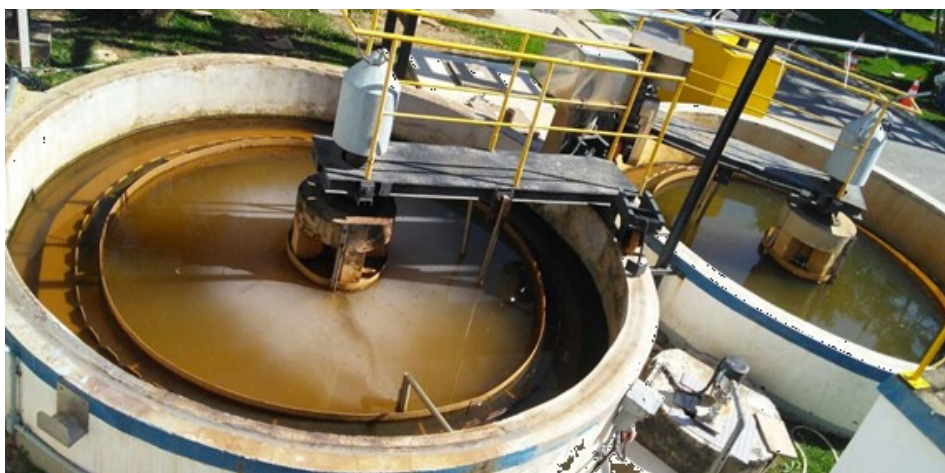
Figura 6 - Decantação final dos efluentes oriundos do reator aeróbio de uma indústria farmacêutica.
