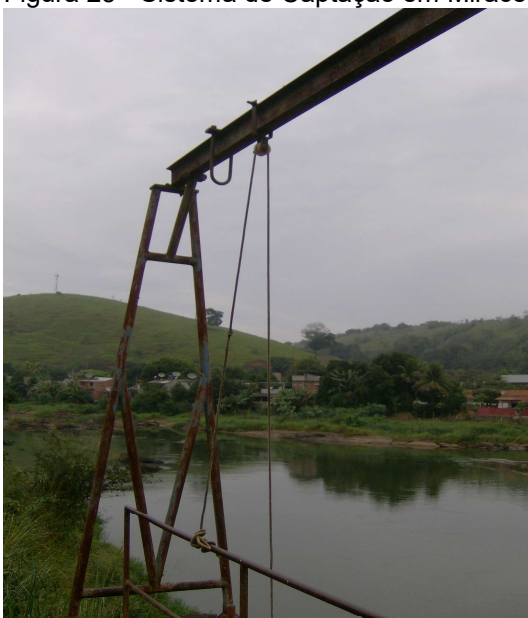
Figura 23 - Sistema de Captação em Miracema (14/06/2017 08:21)
