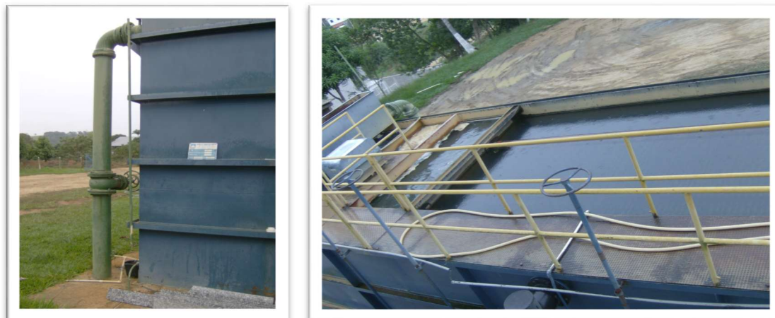
Figura 40 – ETA Compacta Metálica em Aperibé (14/06/2017 – 10:50)
