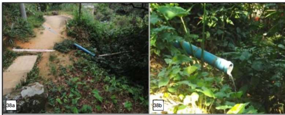
Figura 37 - lançamento de esgoto doméstico in natura no rio. 38a- percurso do encanamento de esgoto; 38b- lançamento de esgoto diretamente no rio Cachoeira.
