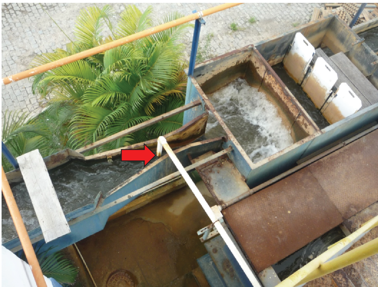
Figura 5 - Ponto de adição do coagulante na Calha Parshall
