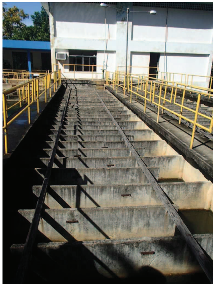
Figura 6 - Floculador hidráulico por Chicana
