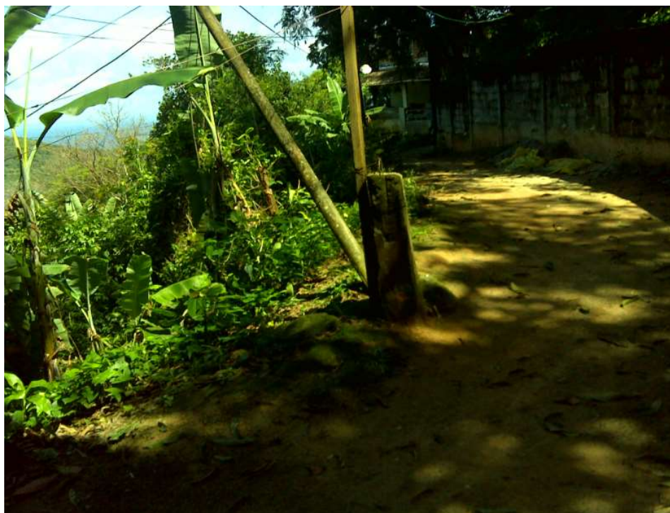
Figura 106- Vista de talude de corte em condições instáveis
