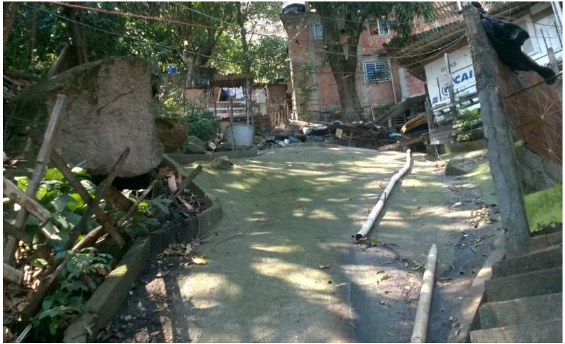
Figura 94- Impedimento à drenagem superficial
