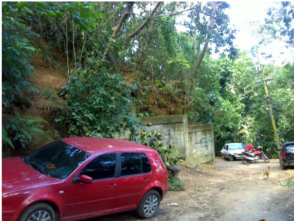
Figura 105- Capa de solo coluvionar contida indevidamente por alvenaria
