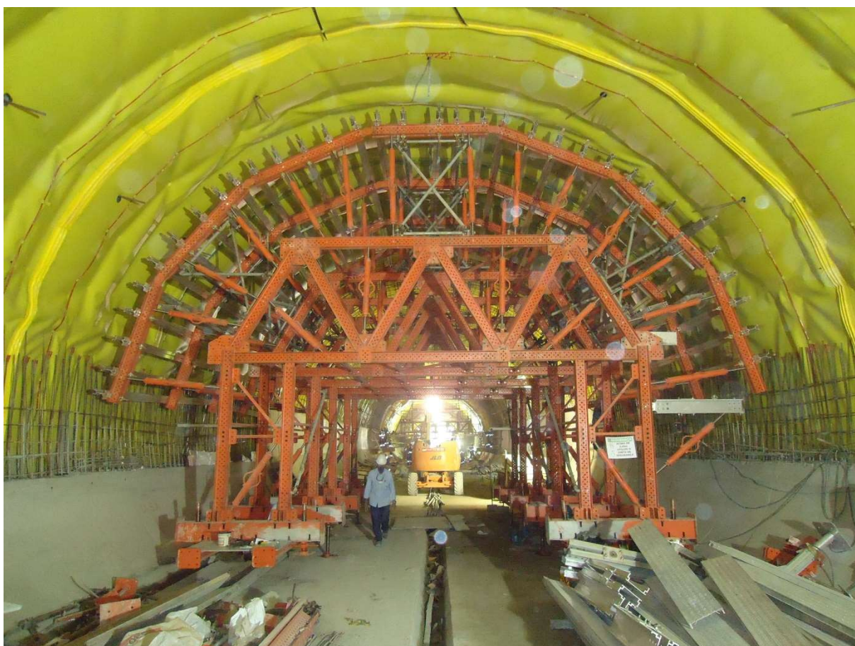
Figura 3 – Pórtico SM Mills – Metrô de São Paulo – SP
