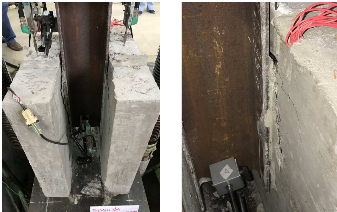
Figura 137 – Fissura da laje de concreto - TP60FB
