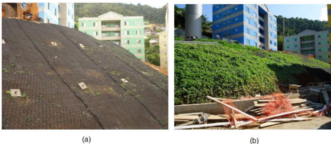
Figura 20 - (a) Talude com a geomanta reforçada e (b) Talude com a geomanta reforçada após o crescimento da vegetação. (Maccaferri, 2011)
