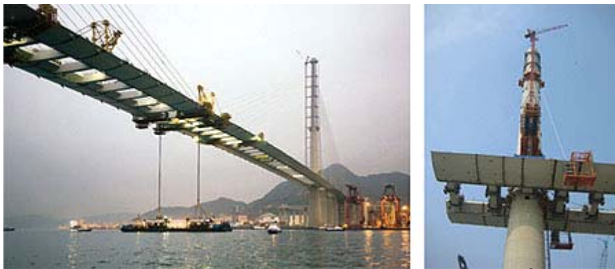
Figura 3.17 - Macaco hidráulico utilizado na montagem da Ponte Stonecutters Bridge, em Hong Kong, China. Disponível em: < http://www.revistatechne.com.br >.
