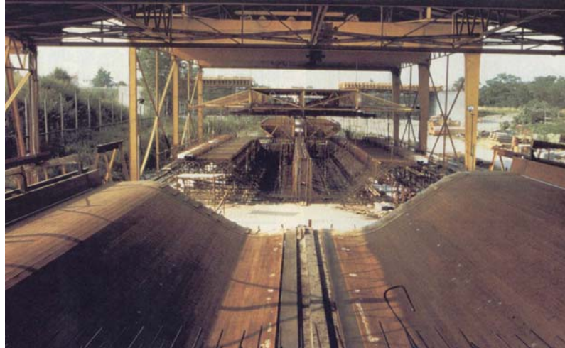
Figura 4.3 - Canteiro com áreas cobertas para montagem de gaiolas de armação e concretagem na ponte sobre o rio Serio, Itália (ROSIGNOLI, 1997 apud WAINBERG, 2002).
