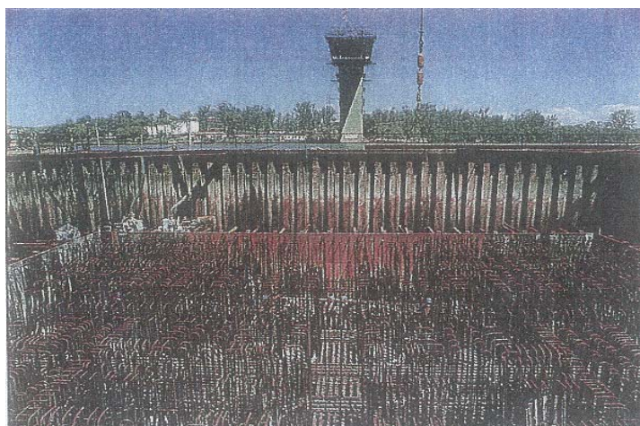
Figura 5.29 - Pier 7: Armadura de aço colocada na base das estacas no interior da ensecadeira (ROTOLONE, 1986).
