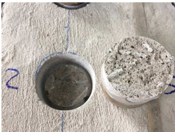
Figura 71 – Detalhe da amostra após o arracamento
