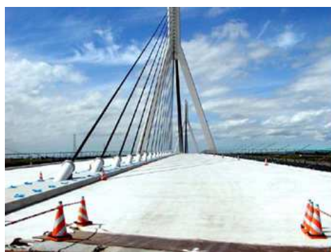
Figura 4 – Construção do tabuleiro da ponte Mihara, em Hokkaido, utilizando-se aço e ECC (LI, 2004).
