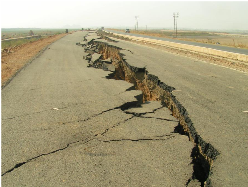
Figura 2 – Ruptura de aterro sobre solo mole (Geosewa, 2019)
