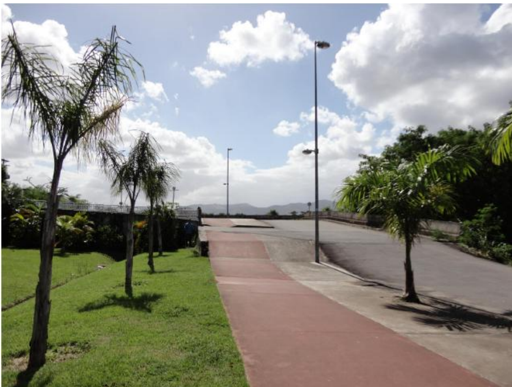
Figura 2 - Recalque em Vila do Pan - Barra da Tijuca, RJ – Entrada de veículos.
