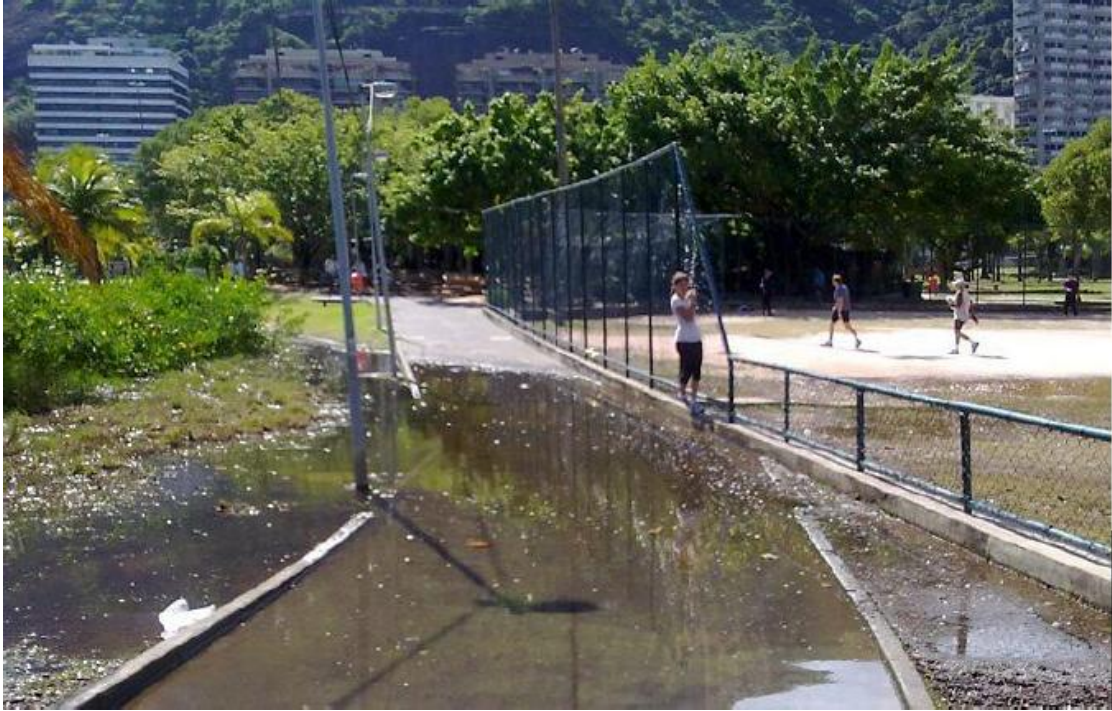
Figura 3 - Recalque em Lagoa Rodrigo de Freitas, RJ
