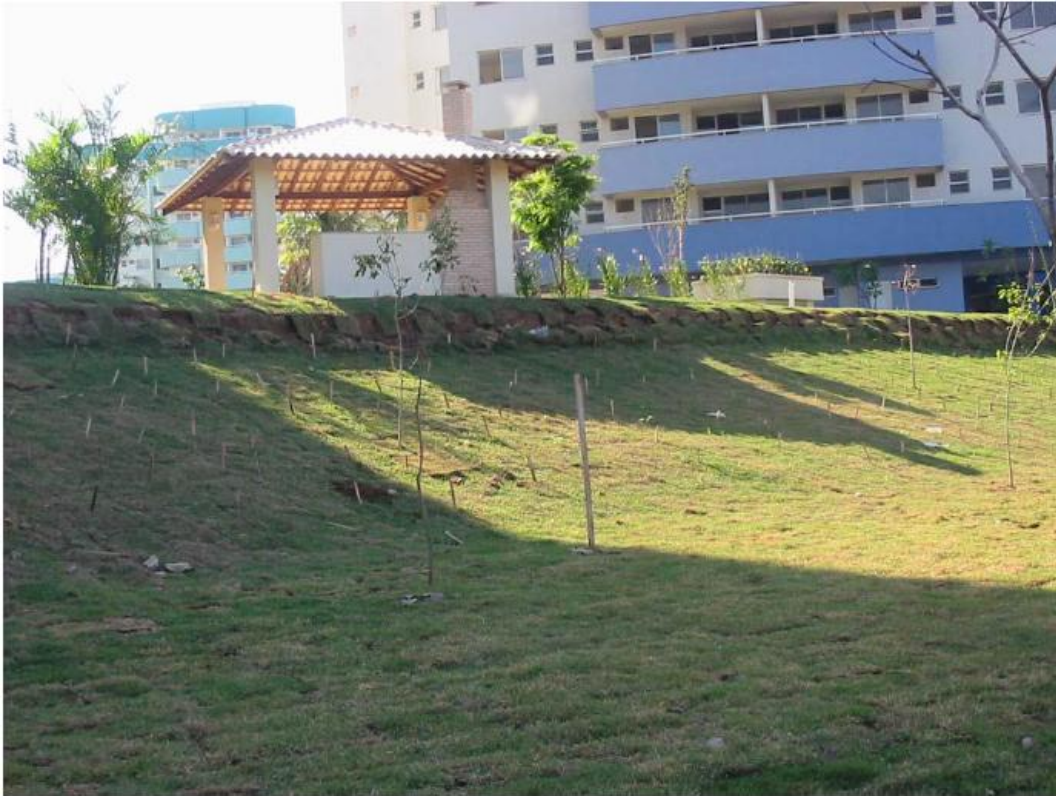
Figura 1 - Recalque em Vila do Pan, Barra da Tijuca – RJ – Talude Lateral.
