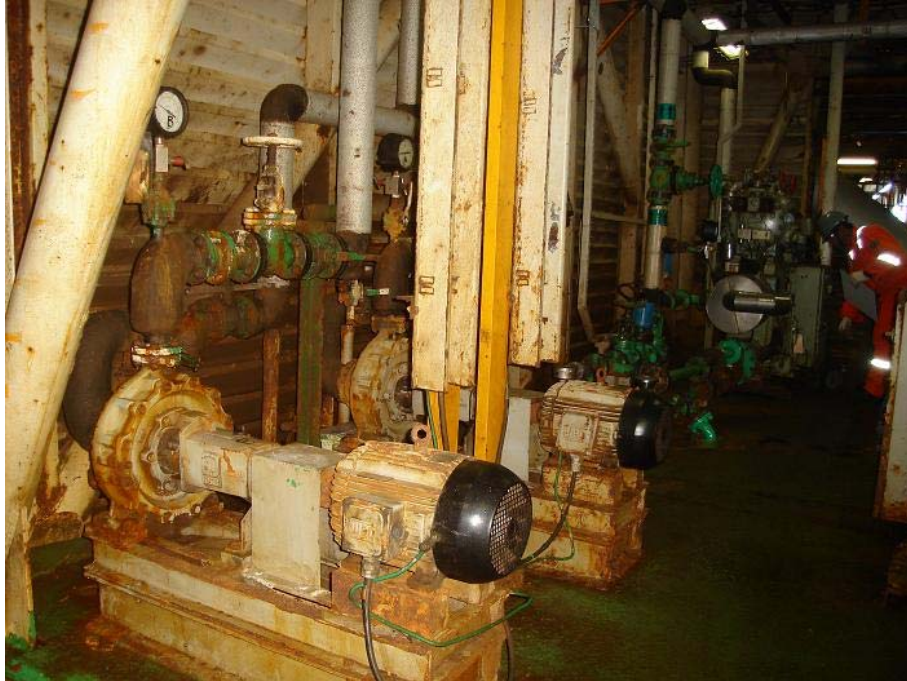
Figura 3 – Bomba de água gelada
