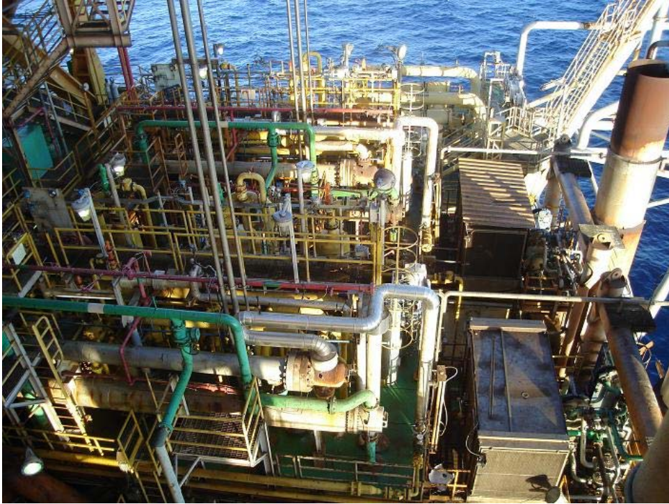
Figura 2 – Vista superior do turbo-compressor
