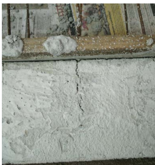
Figura 73 - Fissura de acomodação do concreto na forma, superficial.
