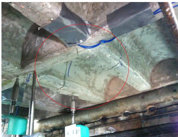
Figuras 186 – Detalhe de fissuras ao longo das nervuras principais de PL-01
