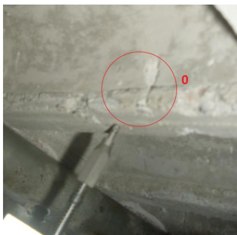
Figura 183 – Detalhe da 1ª fissura de PL-01
