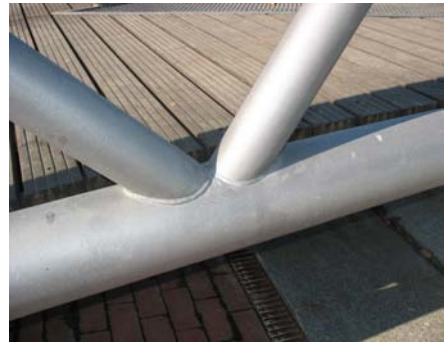
b) Detalhe da ligação da Passarela em Vila Nova de Gaia (Portugal)
