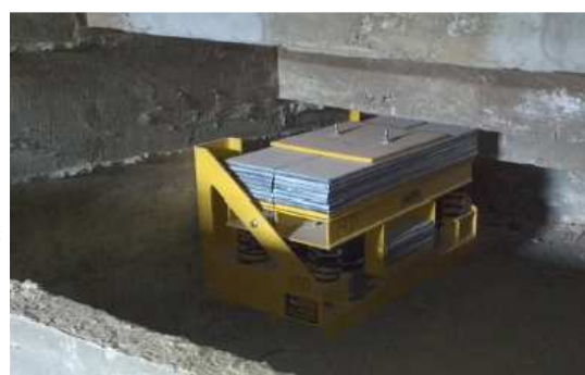
b) ADS locado no balanço da arquibancada
