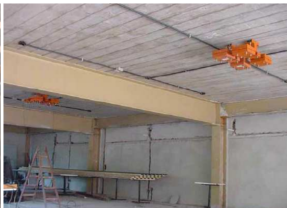
b) ADSs em piso residencial
