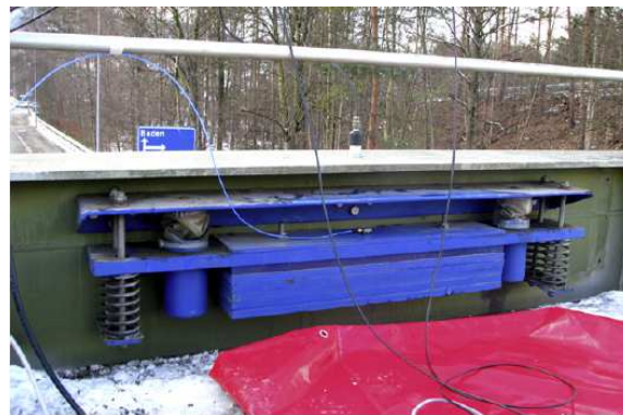
Figura 13 – Dispositivo de controle instalado [36].
