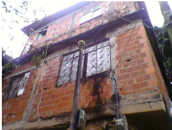
c) Detalhe do fissuramento da parede
