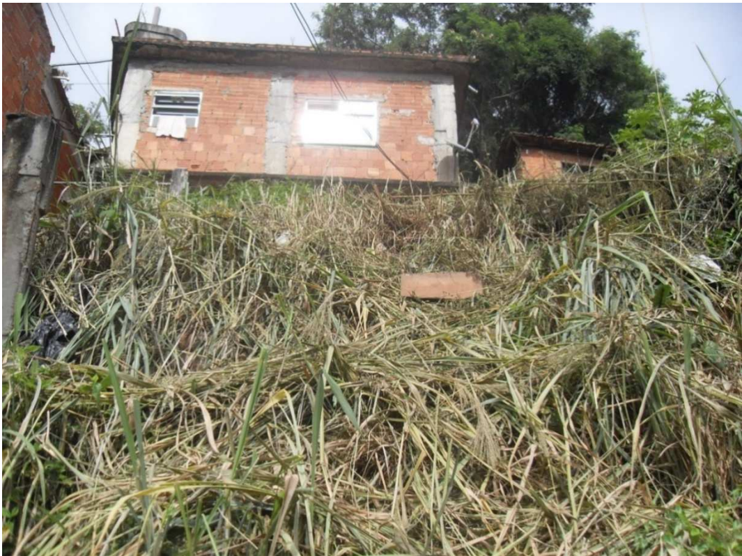
Figura 30. Construção descalçada sobre talude instável
