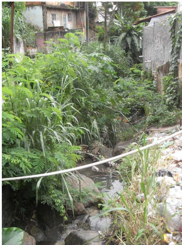
Figura 35. Lixo obstruindo sistemas de drenagem
