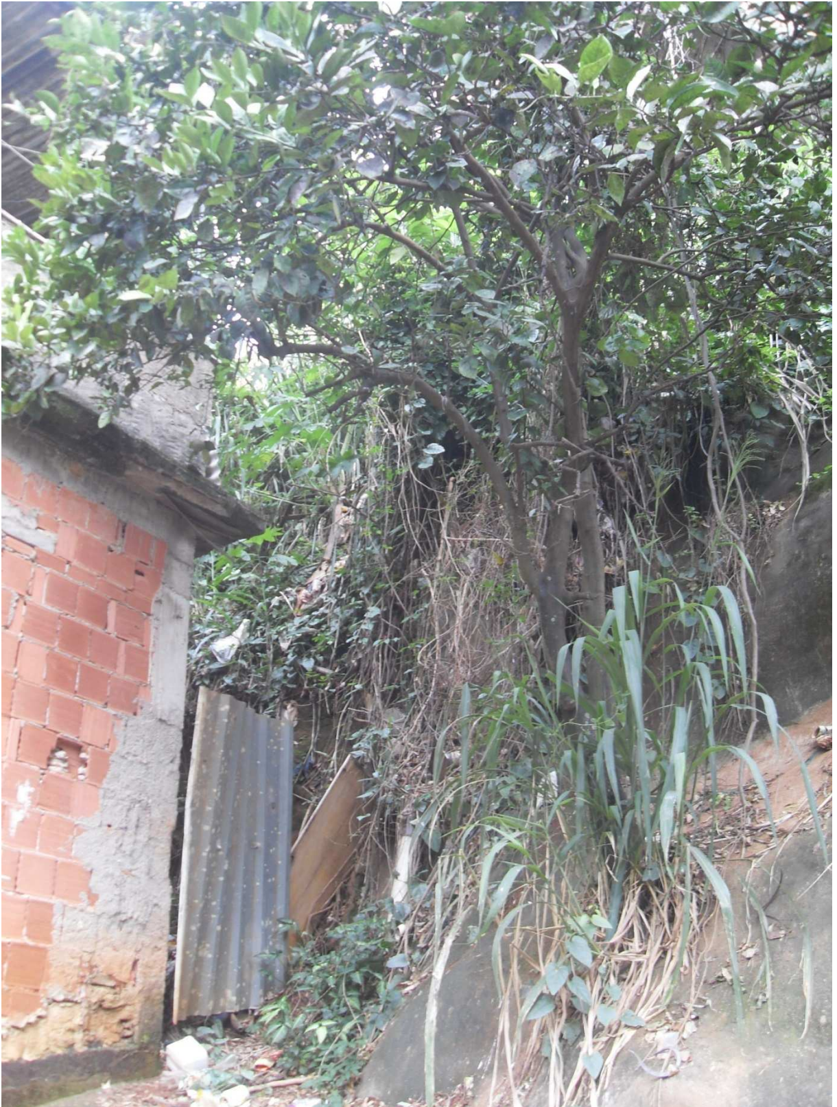
Figura 38. Elevada instabilidade do talude de corte
