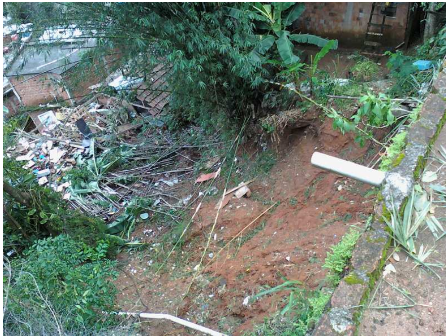
Figura 50. Laudo #1782 - Escorregamento de Solo (aterro) - Vista da casa atingida na rua Maria França 27
