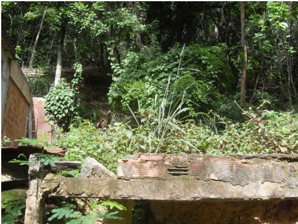
Figura 28. Construções abandonadas em área de alto risco
