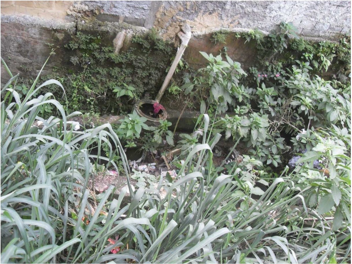
Figura 37. Infiltração concentrada no talude
