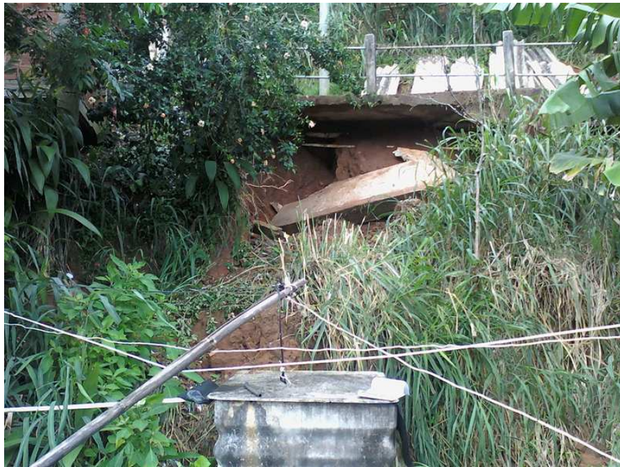
Figura 49. Laudo #1782 - Escorregamento de Solo (aterro) - Vista do pequeno escorregamento que compromete o acesso da comunidade
