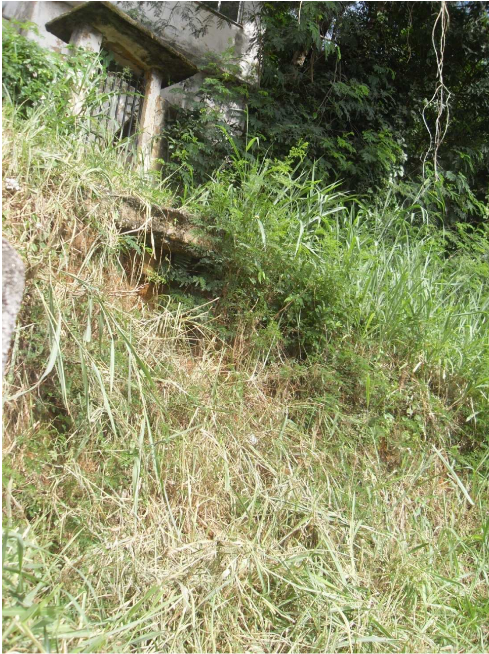
Figura 31. Construção descalçada sobre talude instável
