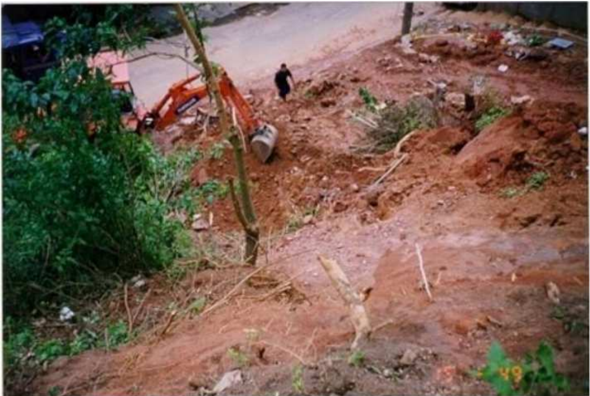
Figura 4. Deslizamento no Morro da Formiga (SILVA et al., 2000)
