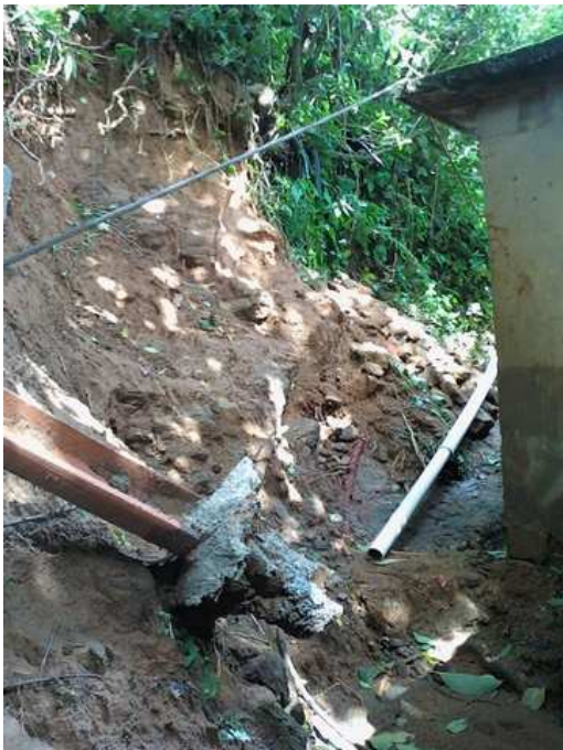
(a) Cicatriz do escorregamento e casa construída muito próxima à encosta.
